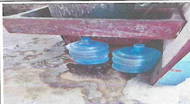
Foto 2: Pila con fuga de agua
