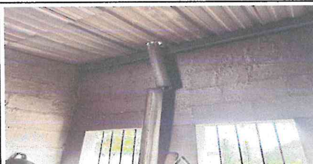
Foto 5: Chimenea en deterioro
