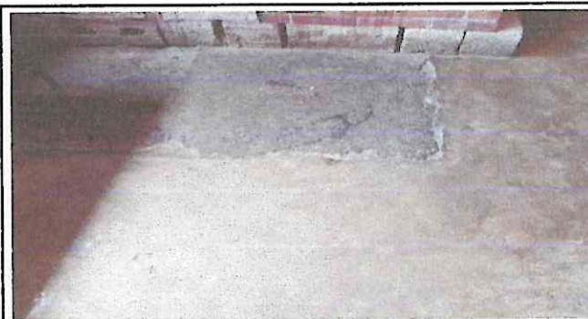
Foto 4: Piso torta deteriorada
